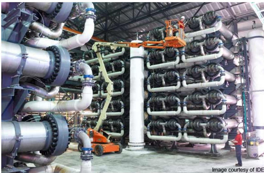
Sl. 8. Unutarnji pogled u postrojenje Ashkelon: 32 RO linije tlačnih cijevi s 40000 membranskih elemenata u obliku spiralnog namotaja
